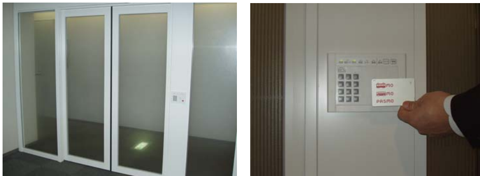
【カードリーダ設置写真（オートドア部）】
